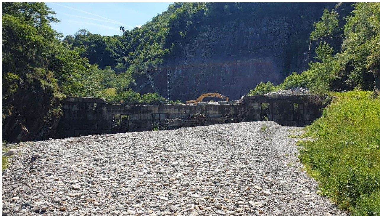
Foto 3: briglia selettiva parzialmente ostruita da legname e sedimenti – Intervento 3
