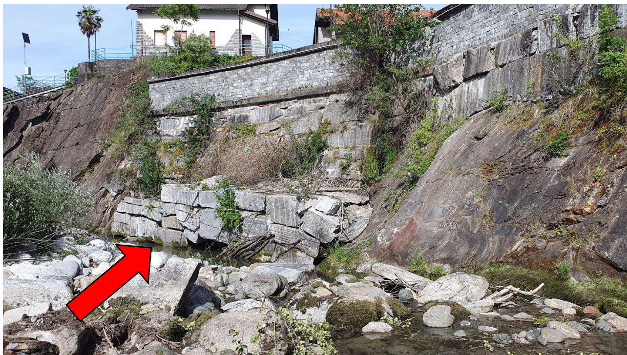
Foto 1 : scogliera sponda destra completamente disarticolata- Intervento 1
